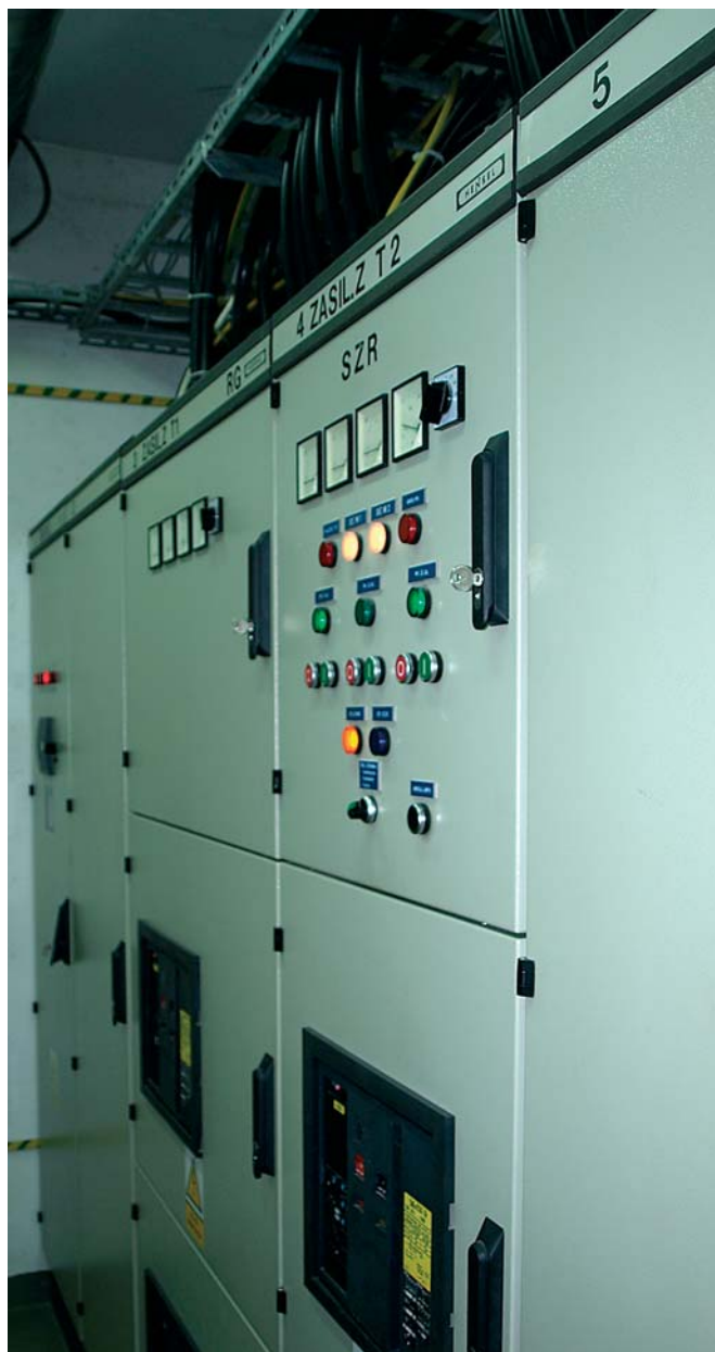
Rys. 2. Moduł automatyki wraz z elementami wykonawczymi może być zamontowany w szafie
